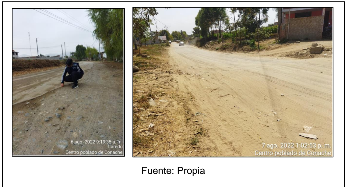
Figura 8. Estado actual de la vía en el centro poblado de Conache.
