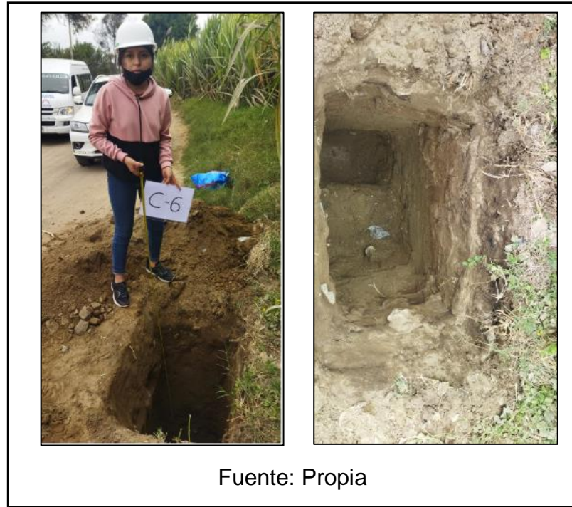
Figura 16. Excavación de Calicata 06 en el Tramo 02 (Conache – Pampas de San Juan – La Rinconada).
