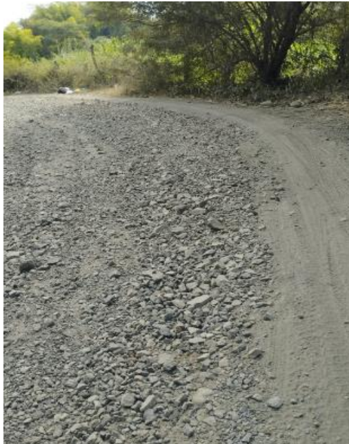
Figura 5. Material suelto en tramo Batanes – San Pedro
