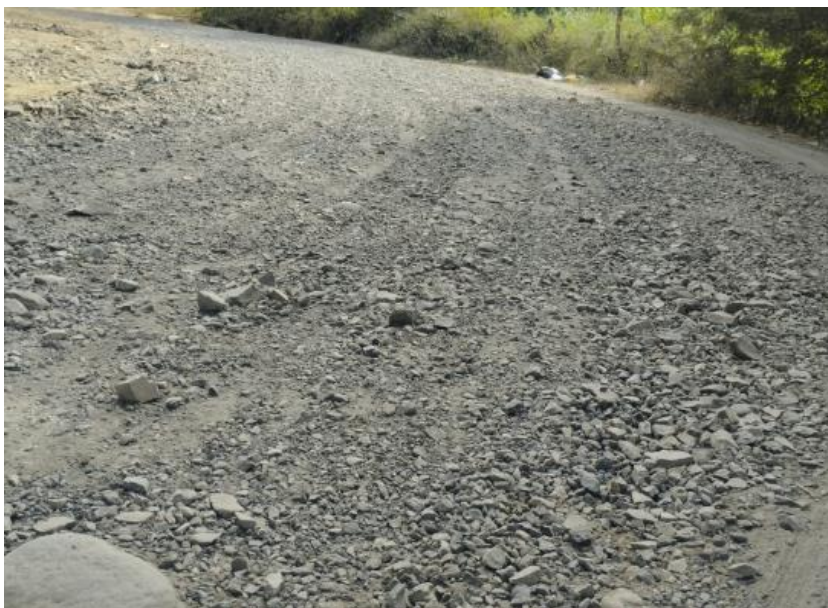
Figura 4. Estado actual del tramo Batanes – San Pedro
