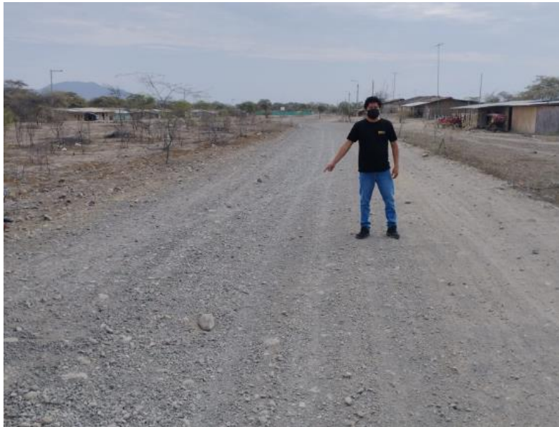
Figura 18. Estado del tramo Batanes – San Pedro
