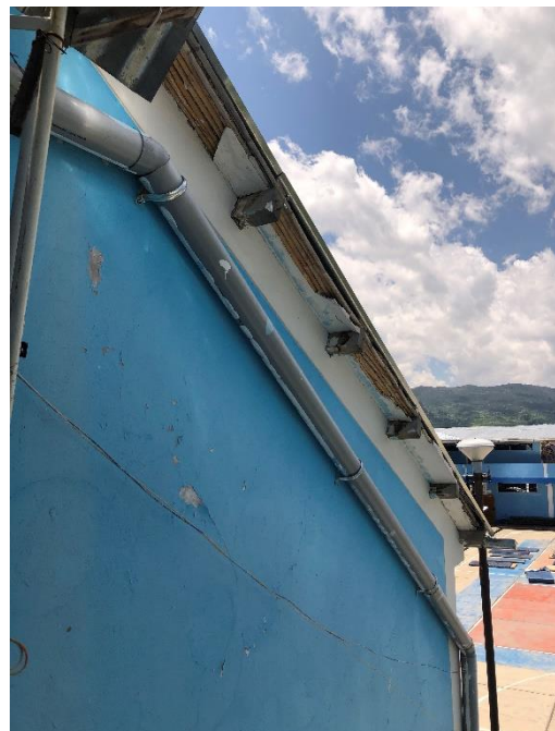
Figura N° 19 Deterioro de la Cobertura Ligera de Quincha.
