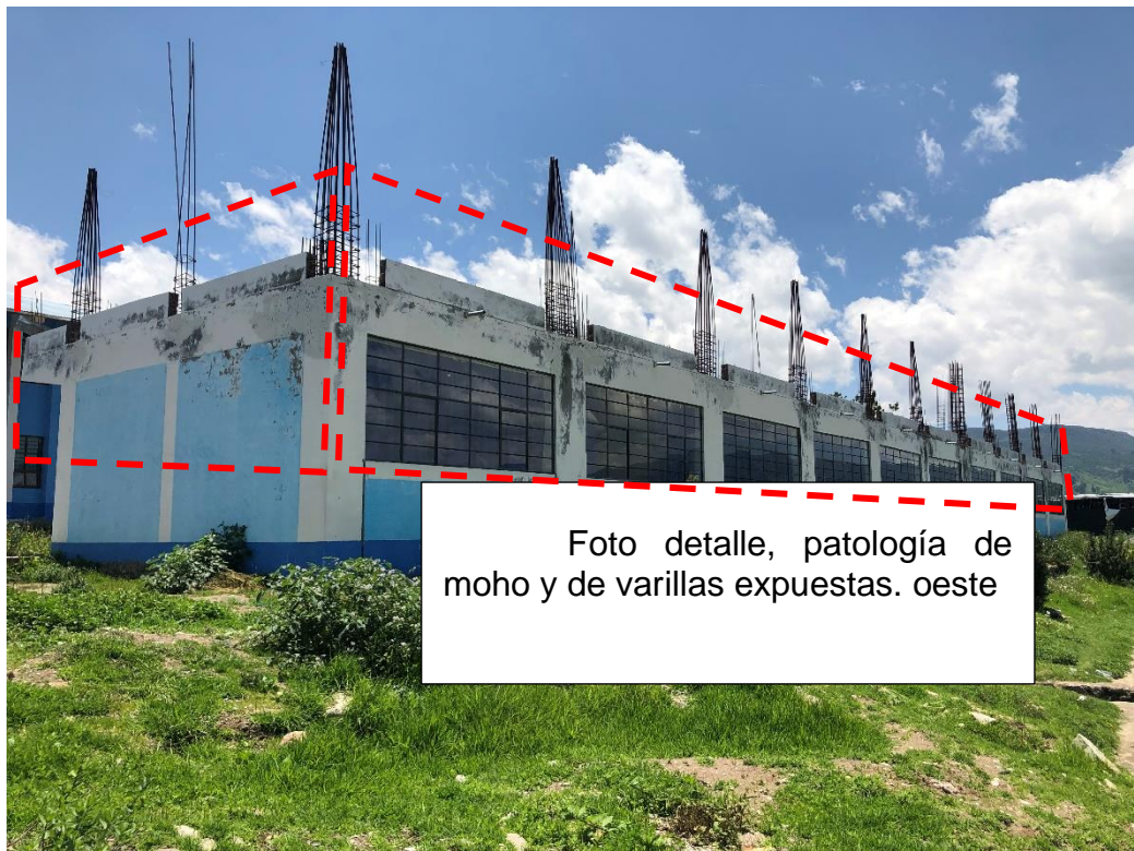
Figura N° 30 Deterioro de la Superficie del Muro y Acero expuesto a la Humedad.
