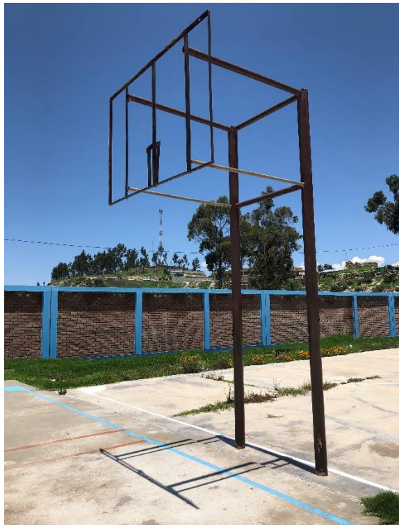
Figura N° 149 Estructura Metálica de Basquet en Proceso de Oxidación por Lluvias Continuas.
