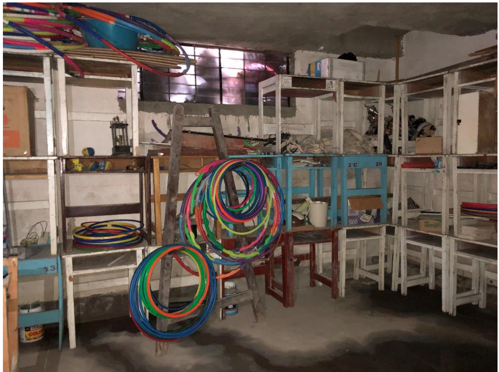
Figura N° 117 Depósito de Deportes con Agua Estancada.
