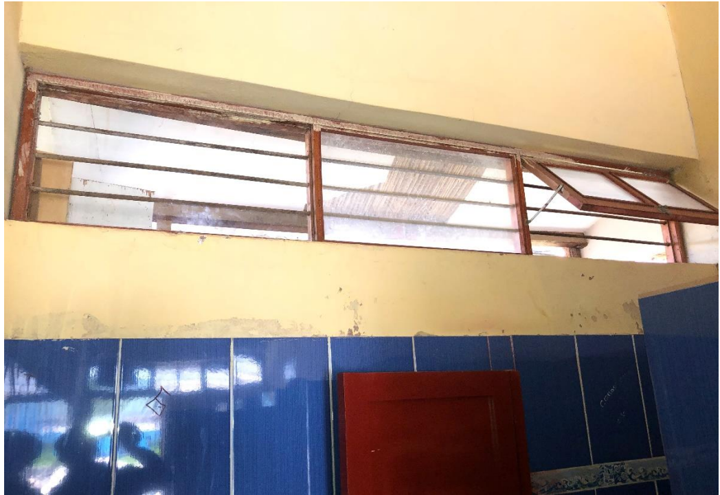
Figura N° 140 Ventilación de Módulos de S.h. de CEBA hacia el Taller de Carpintería, Pabellón N° 6.
