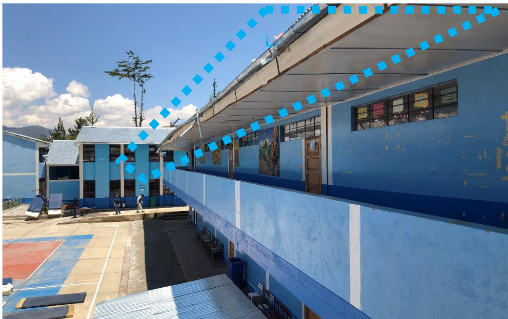
Figura N° 25 Debilitamiento del Cielo Raso del Segundo Nivel del Pabellón N°2.
