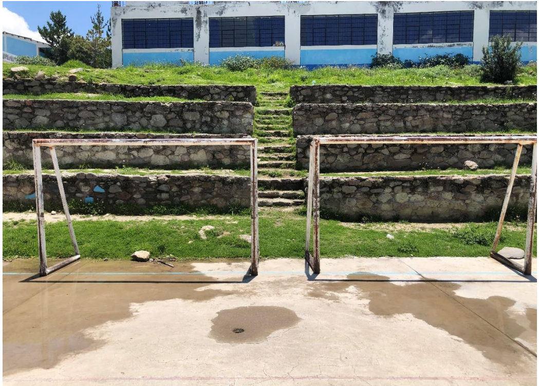
Figura N° 148 Gradería de Mampostería, Zona Sur, Presencia de Sedimentos y Maleza en su Estructura y Desgaste en la Circulación Central.
