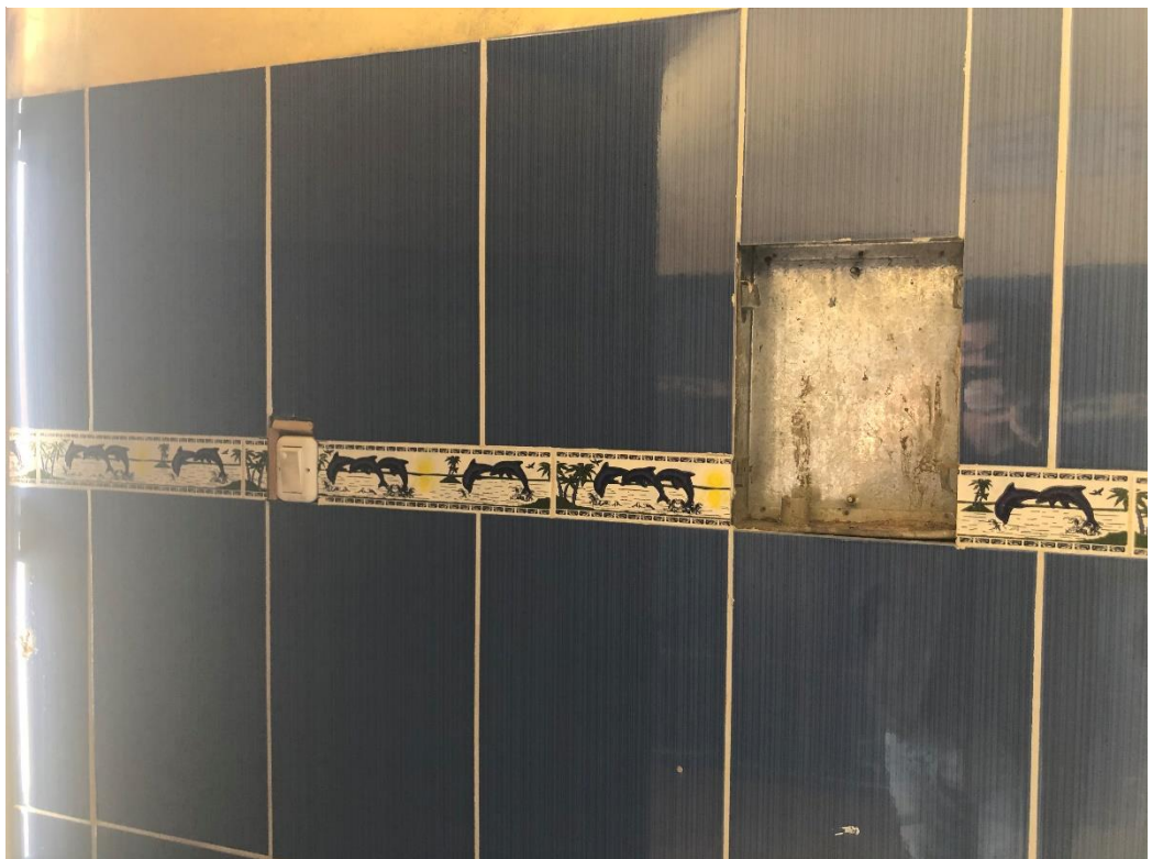
Figura N° 141 Instalaciones Electricas Incompletas, con Errores en la Ejecución, CEBA, Pabellón N°6.
