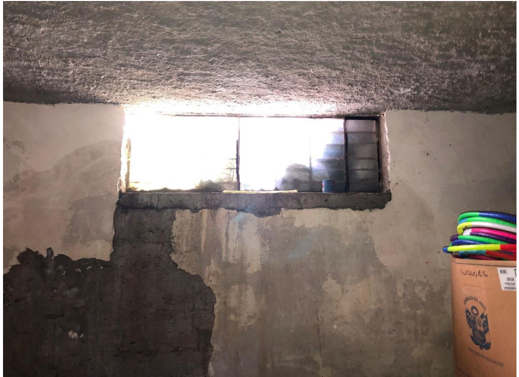
Figura N° 116 Deterioro de los Muros Perimetrales del Depósito de Deportes.
