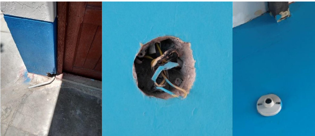
Figura N° 113 Instalaciones eléctricas Incompletas y en Mal Estado
