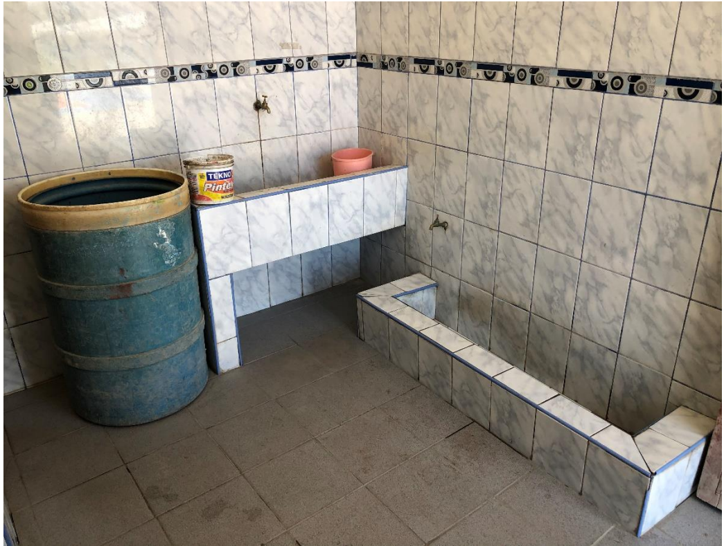
Figura N° 131 Reservorio Provisional de Agua Potbale, S.H. de Estudiantes – Varones, Pabellón N°2.
