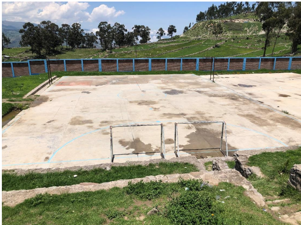
Figura N° 44 Losa Tipo II, Zona Sur, Estructuras de Concreto y Acero Deterioradas.
