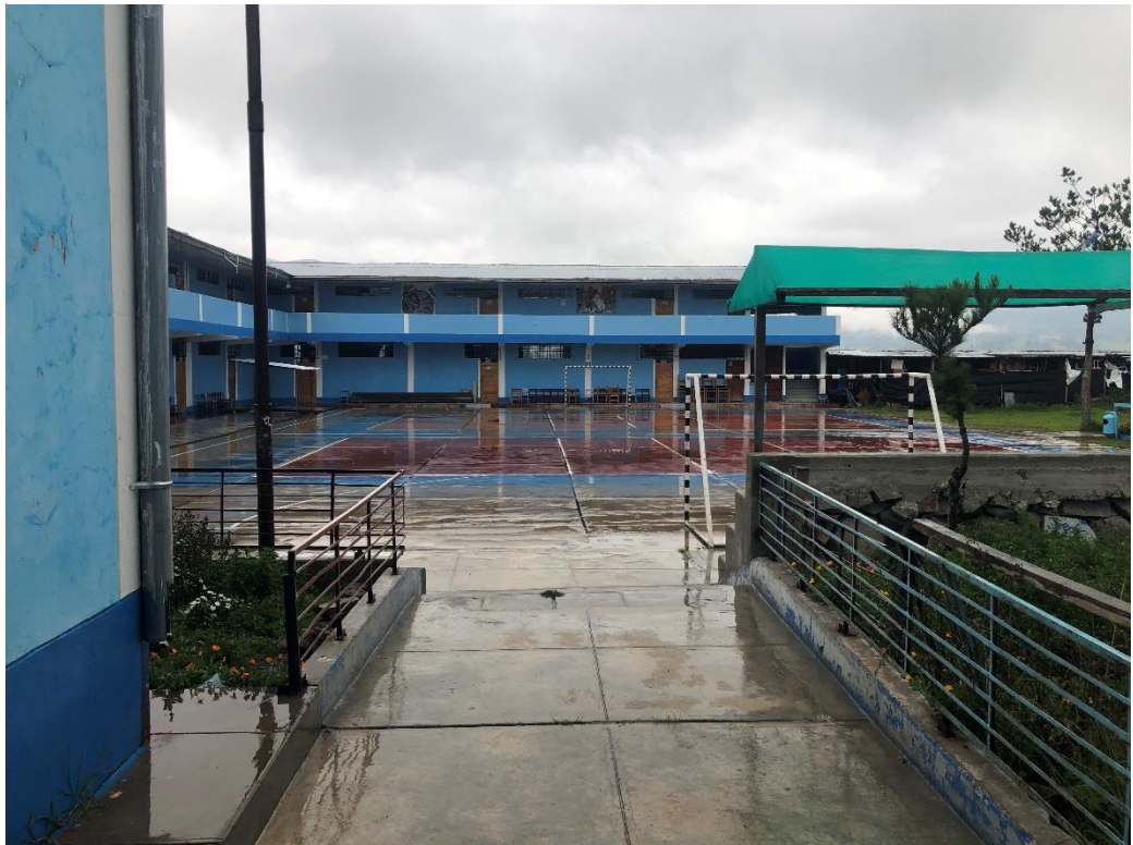
Figura N° 45 Agentes Hídricos en Continua Erosión de la Losa Tipo I, Pabellón N°2.
