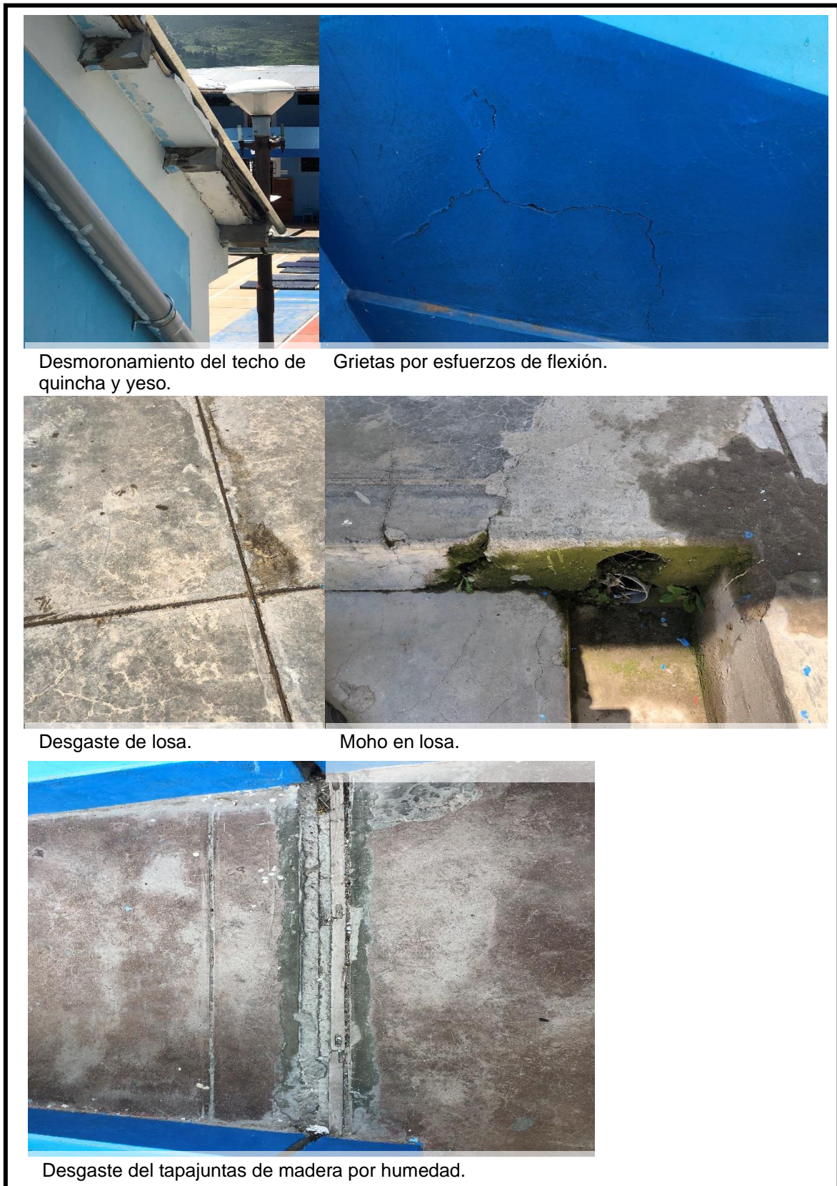
Figura N° 110 Patologías del Pabellón N°1, 2020.
