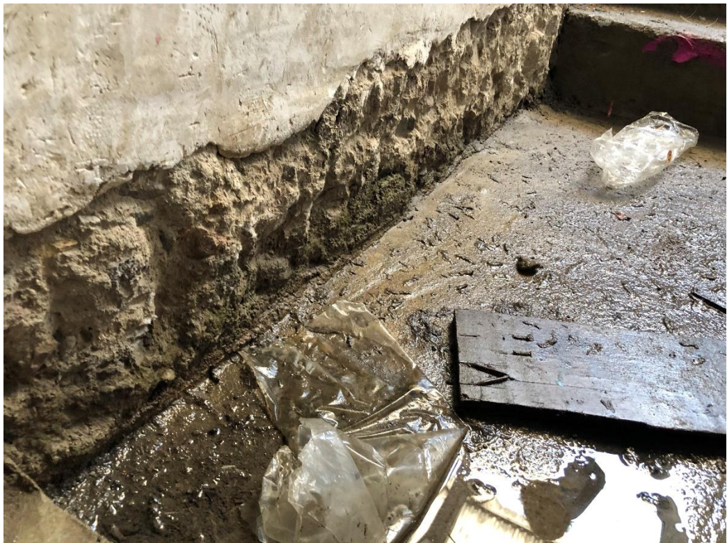
Figura N° 115 Degradación del Muro por Humedad del Depósito de Deportes.
