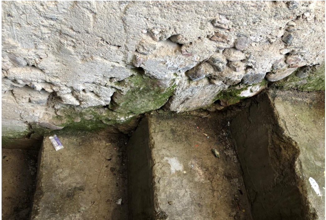
Figura N° 114 Patologías por Humedad en el Ingreso del Depósito de Deportes.
