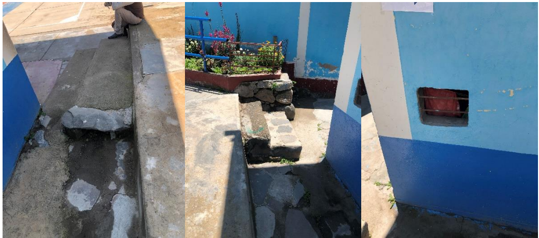
Figura N° 24 Patologías por Humedad de la Losa de Concreto.
