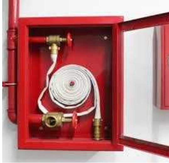
Imagen N°36: Gabinete contra incendios
