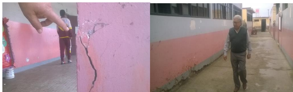
FIGURA N° 34: Infraestructura interna dañada del centro educativo politécnico
